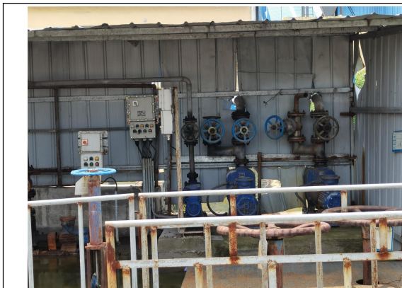
初期雨水、事故水切换阀
